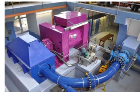
Salle des machines
